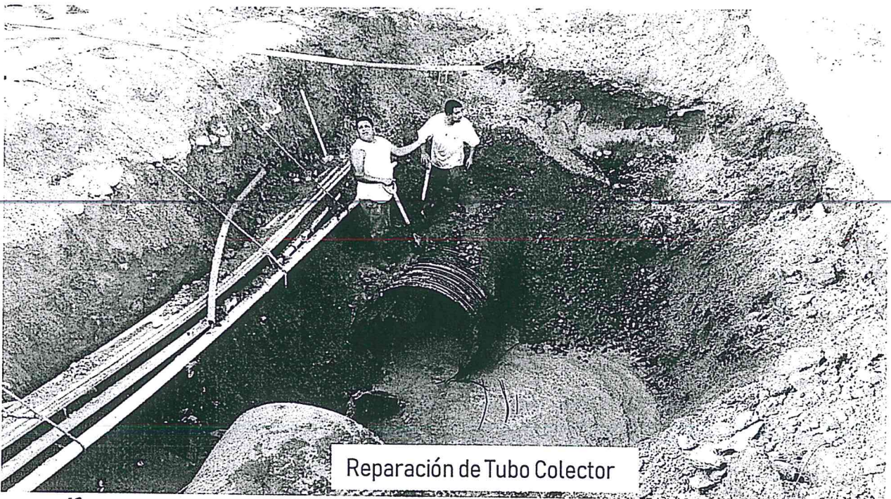
Tubo Colector de 48" (Caudal de 750 l/s)
